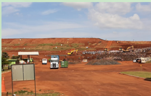
Figura: Aterro Sanitário - CGR Guatapará e coleta de chorume
